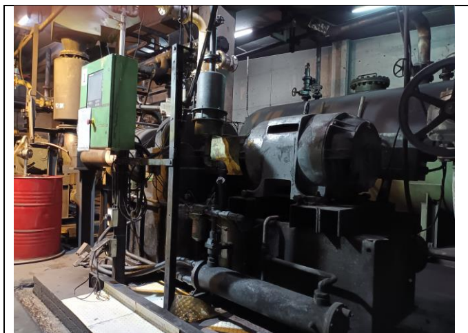
軋鋼廠空壓機
